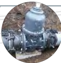
農水パイプライン スポンジMジョイント バルブ取り替え工事現場
